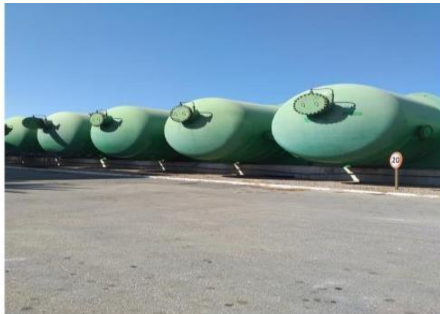
Figure II.7 : Les filtres à sable
