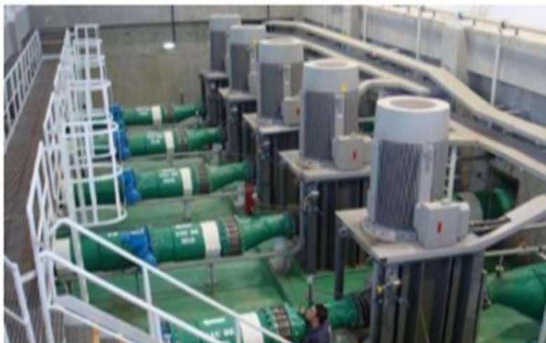
Figure II.5 : Station de pompage de l'eau de mer
