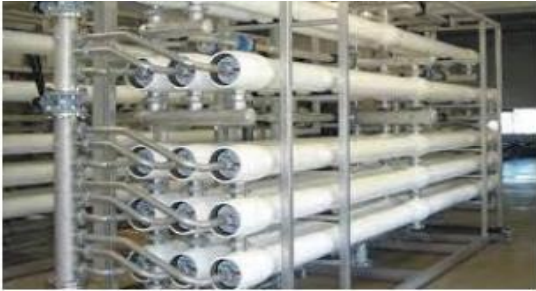
Figure II.11 : Châssis d'osmose inverse
