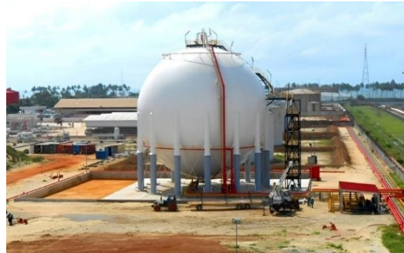
Figure I. 8: Sphère de Stockage
