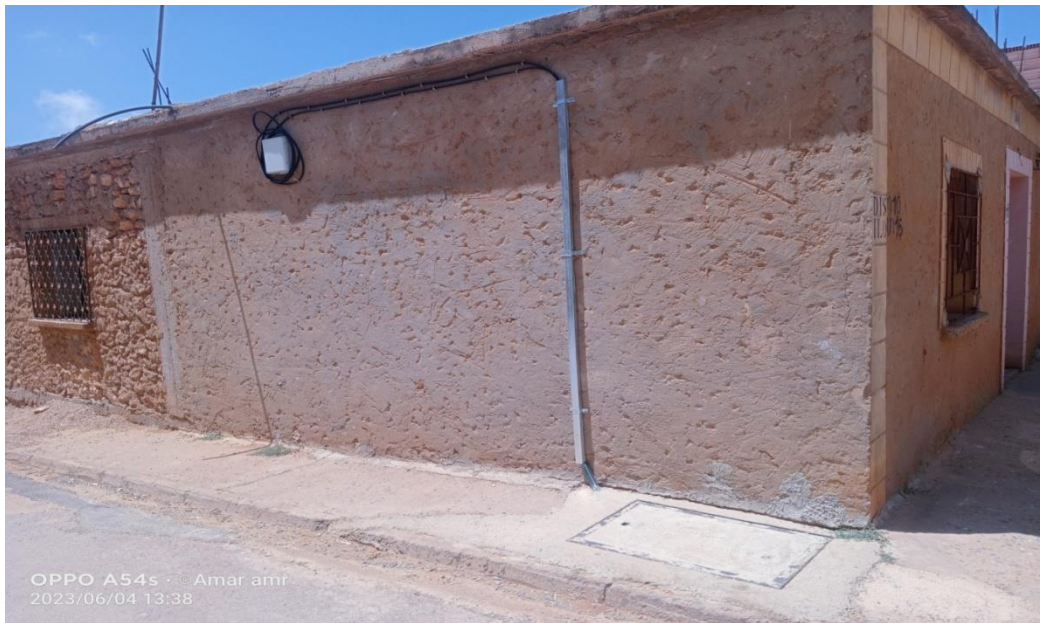
Figure III.17: Emplacement de FAT et de chambre de distribution A2 (photo réelle).
