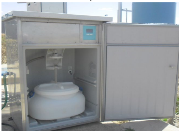
Figure n°21 : Préleveurs automatiques à l'entrée et sortie de la STEP
