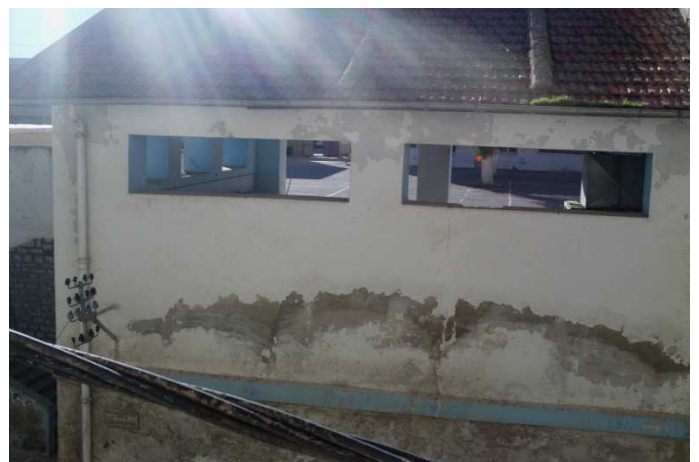
Figure 3-29: l'humidité sur le mur extérieur Source : Photo prise par l'auteur
