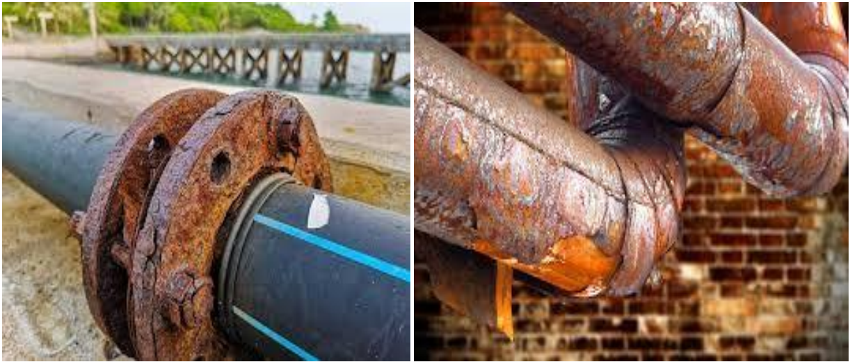
Figure III-7 : Corrosion des métaux.
