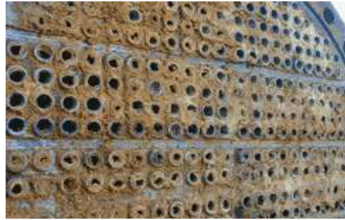
Fig. (IV.16) : L'encrassement dans un échangeur tubulaire.
