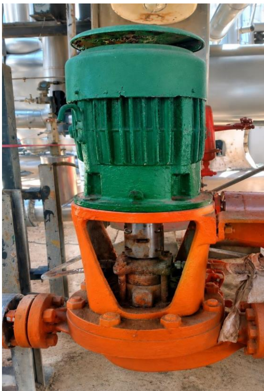
Figure II.1 : Pompe de reflux J-725/27 sur site.
