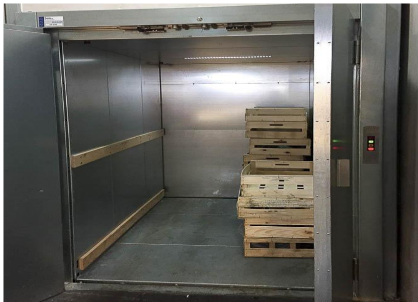
Figure 4 : Ascenseur de charge [5].
