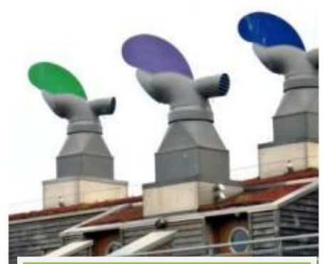
Figure 23 : Capteurs de vent
