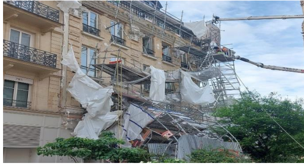
Figure II.6 : Effondrement d'échafaudages en séries - Paris 6 mai 2026 Cette image montre l'effondrement d'un échafaudage sur la façade du magasin Zara de la rue de Rivoli, à Paris 6 mai 2026
