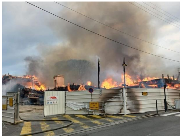
Figure II.8 : Incendie d'une école à Montfermeil (93) Chantier quasi-achevé de l'école maternelle Jules-Ferry, à Montfermeil 15 avril 2023, Source: © (Copyright) Twitter Pompiers de Paris
