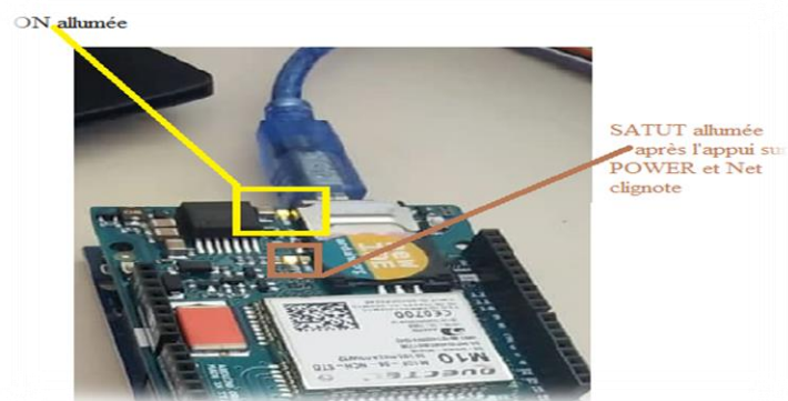
Figure 3. 8 : Shield sous tension
