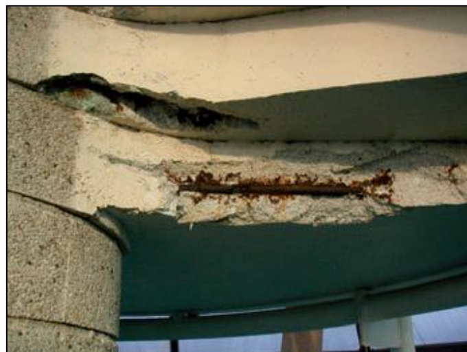
Figure3.3 : Corrosivité du béton (armatures avec éclatement)
