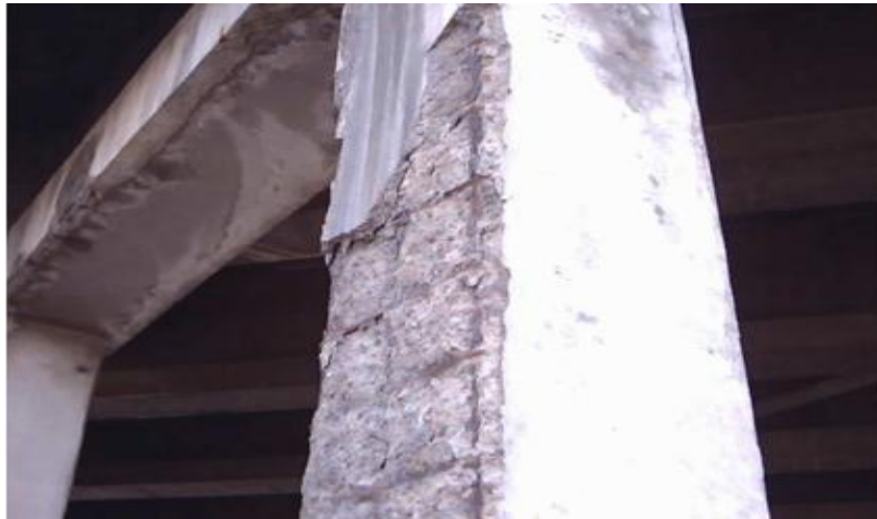
Figure 3.26: Décollement du parement du pilier et fissuration du chevêtre
