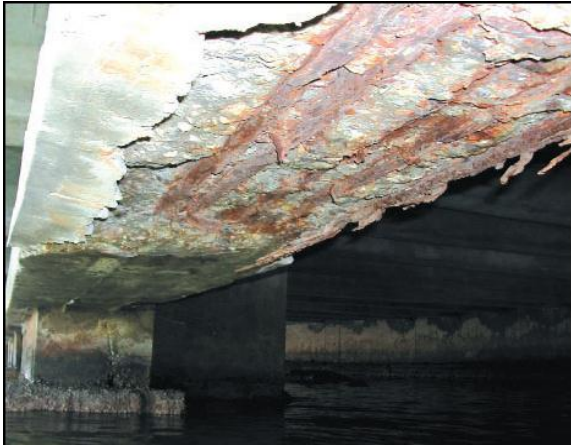
Photo (c) : Corrosion importante en sous face chevêtre d'une poutre pont.
