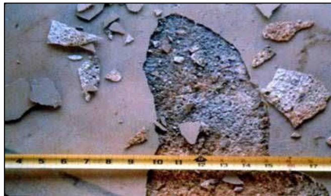
Figure 2.4:Délamination d'une dalle
