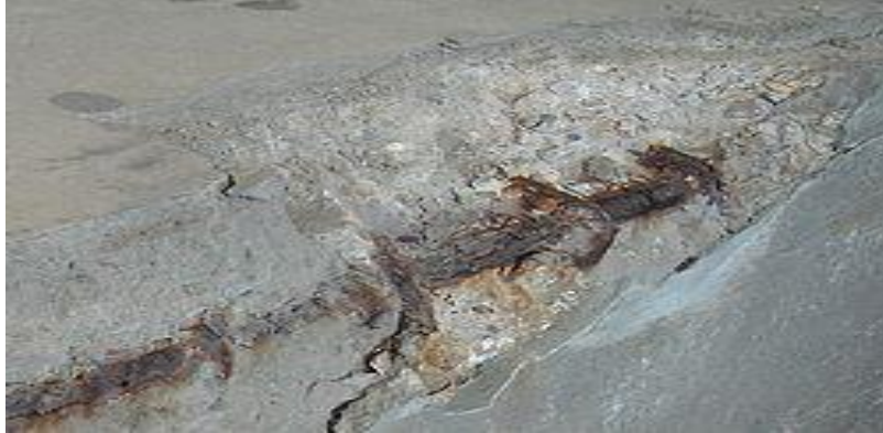
Figure 3.15: Éclatement du béton dû à la carbonatation
