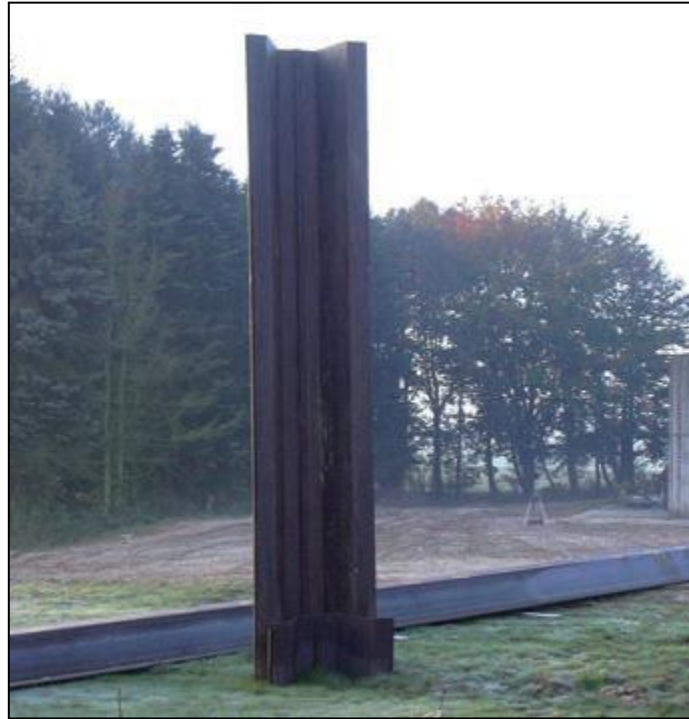
Figure3.2 : corrosivité des sols (Palplanche en acier).
