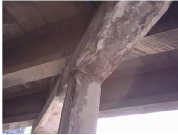
Photo (d) : Oxydation générale d'un Pont
