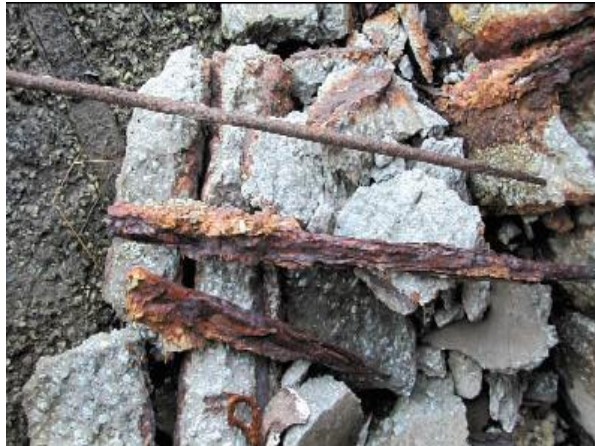
Photo(b) : En se corrodant, les aciers augmentent de volume(en bas), comparé à une armature saine(en haut).
