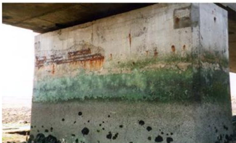
Figure 3.8: Pile en zone de marnage.
