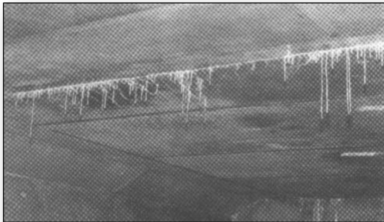
Figure 1.5: Contamination par les sels de dégivrage
