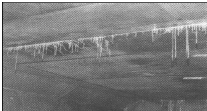
Figure2.1: fissuration et contamination par les chlorures d'une poutre caisson.
