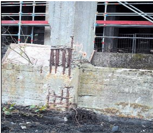
Photo(a) : Corrosion par carbonatation des aciers sur un départ de poteau.
