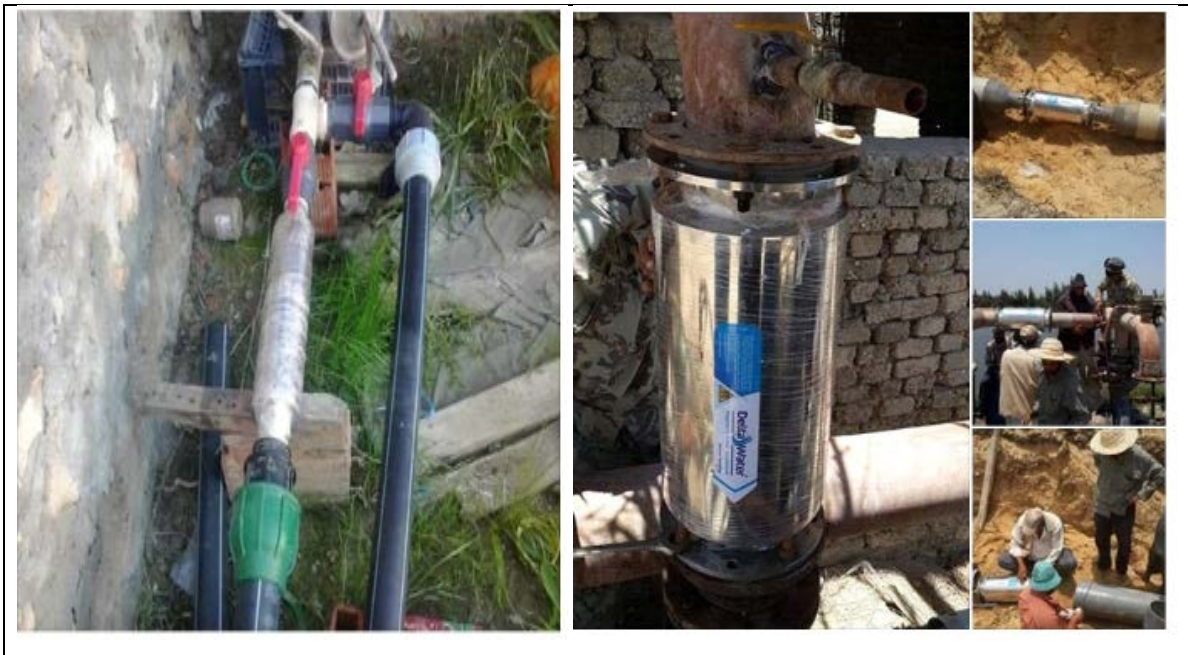
Figure 11 : L'installation de l'appareil Delta water (Marweni H, 2015).
