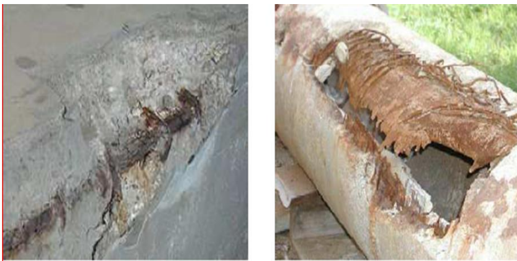
Figure II. 5 : Carbonatation et corrosion des armatures (Boutaraa 2021)
