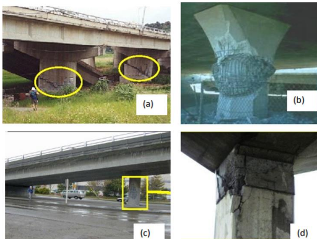
Figure I. 6: Exemples de défaillances des ponts durant le séisme de Kobé 1995 : (a) rupture de piles par effort tranchant, (b) flambement des armatures longitudinales avec éclatement des armatures transversales, (c) endommagement de la pile par flexion-cisaillement et (d) éclatement de béton de colonne (Boutaraa, Z. (2019))
