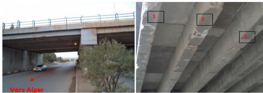
Figure II. 19: Poutres Endommagées par les Chocs des véhicules.
