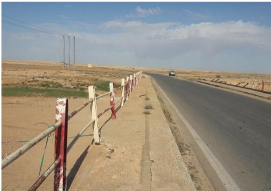
Figure III. 17: Dégradations visuelles des équipements du pont
