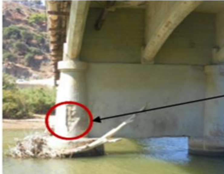
Figure I. 3: Désordre à la base des piles du pont sur Oued Allala (Ténès-Algérie) sous l'effet de l'abrasion (Boutaraa, Z. (2019))
