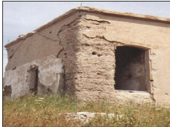
Figure II. 16: Dégradation d'un ouvrage soumis au gel- dégel.
