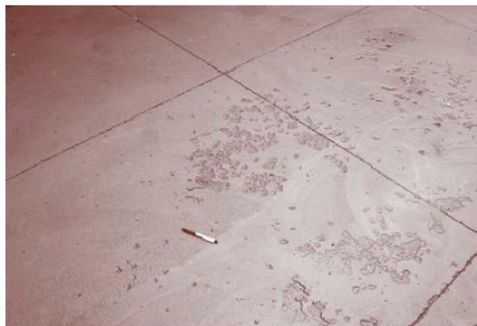
Figure II. 17 : Ecaillage d'une dalle de béton.
