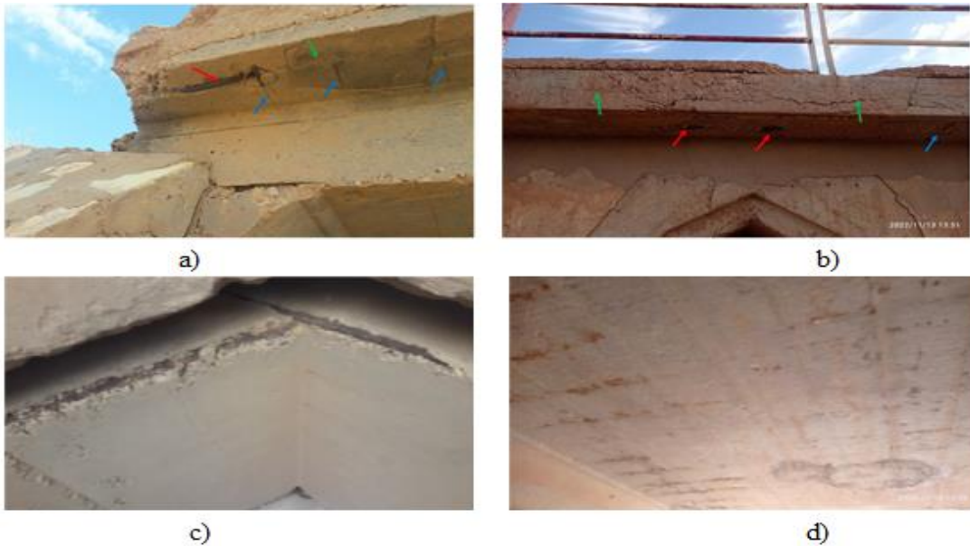
Figure III. 15: Dégradation visuelle de la superstructure du pont
