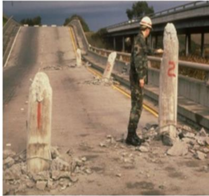
Figure I. 5: Poinçonnement du tablier sous l'effet de la composante verticale du séisme de Loma Prieta (USA 1989) (Kibboua, A. 2012, mars)
