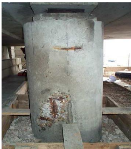
Figure II. 12: Eclatement du béton dans une pile de pont
