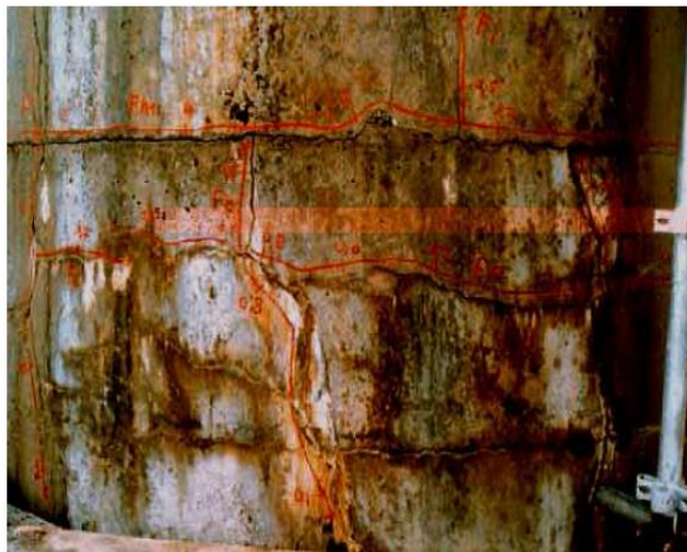
Figure II. 8: Fissure dues au gonflement interne (Divet, L.2003)
