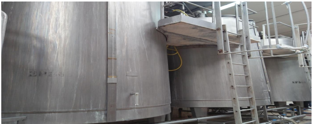
Figure 03: Les tanks de recyclage utilisés par la laiterie Giplait
