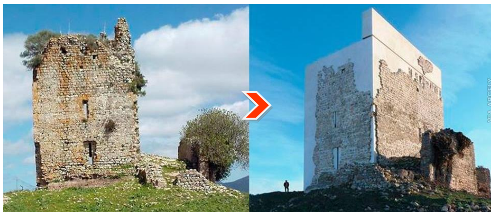
Figure 3.4 : Restauration d'une tour du château mauresque de la Matrera, Cadiz-Espagne tout en modifiant l'apparence
