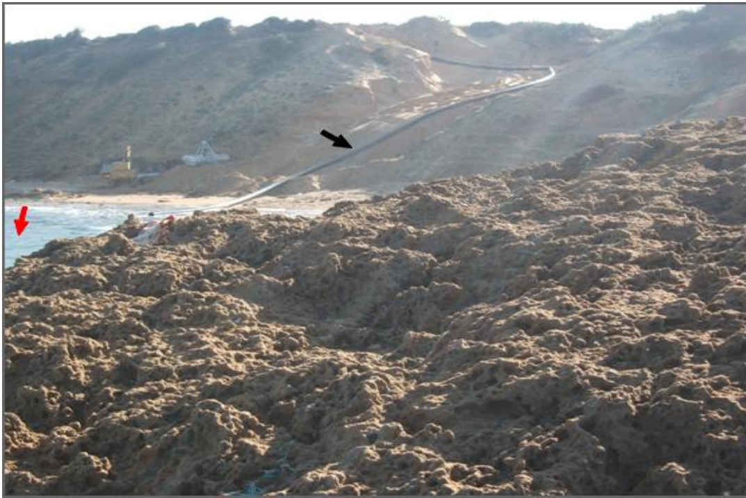
Figure B : Installation d'une canalisation des eaux usées (flèche noire) de la ville de Stidia. Ces eaux usées vont être directement déversées au niveau de la station SS3 (flèche rouge) du site de Stidia. Photos prises en Février 2012.
