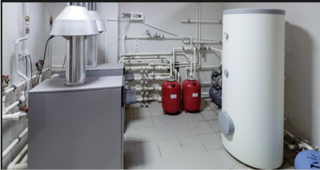
Figure 440. Chaudière collective haute performance énergétique
