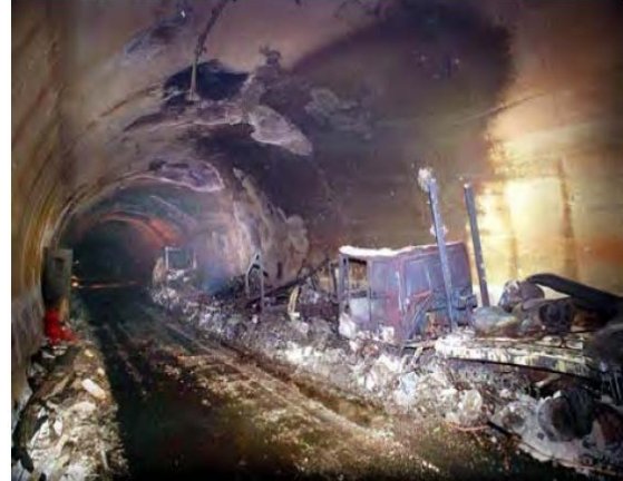
b) Mont Blanc : éclatement du béton.
