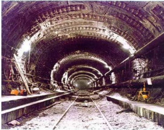
a) Tunnel sous la Manche : fort écaillage du béton.
