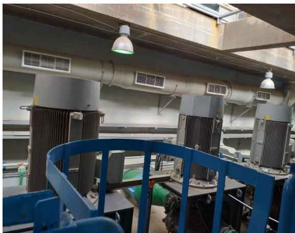
Photo III.2. : Le captage et pompage de l'eau de mer
