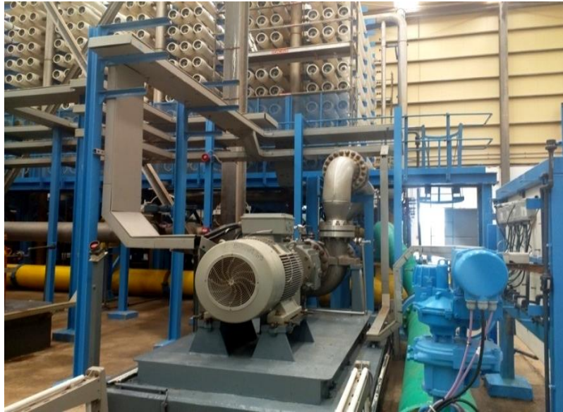
Photo III.7 : la pompe Booster
