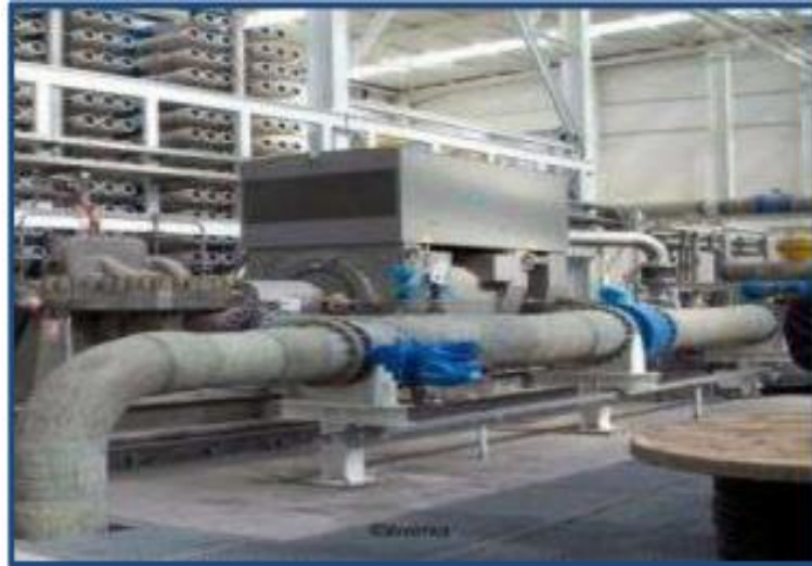
Photo III .5 : Pompe à haute pression
