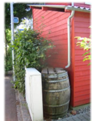
Figure 79: les citernes de récupération des eaux pluviales
