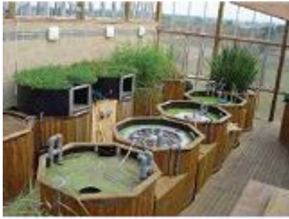
Figure 65: les cuves de l'épuration des eaux usées
