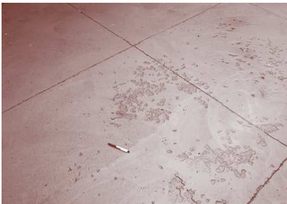
Figure 1.10 Ecaillage d'une dalle de béton
