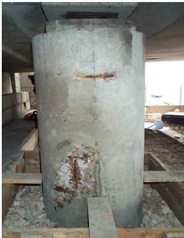
Figure 1.8 éclatement du béton dans une pile de pont
