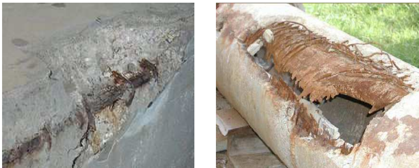
Figure 1.2 Carbonatation et corrosion des armatures
