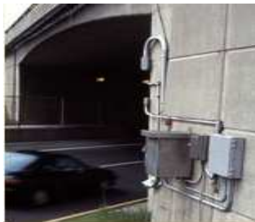
Figure 5.4 Alimentation d'une protection cathodique d'armatures dans un pont
