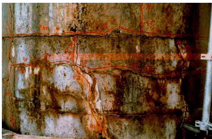
Figure 1.6 : Fissuration dues au gonflement interne
