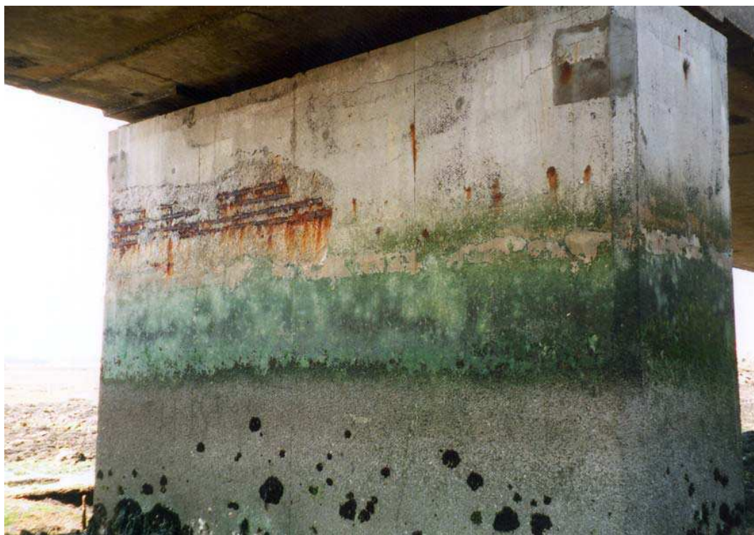
Figure 1.9 Dégradation causée par l'eau de mer sur les piles d'un pont
