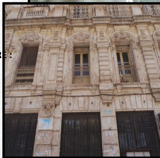
Figure 93 : Photos de la pathologie Source : Auteur
