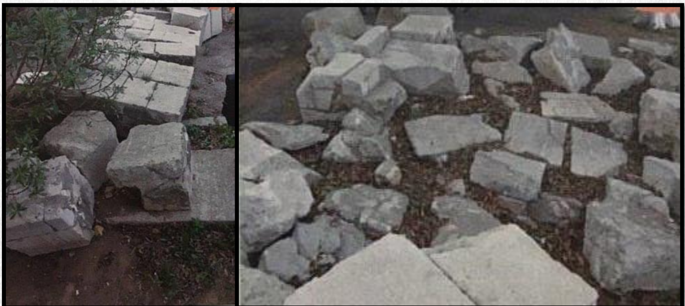
Figure 82 : Rupture des pierre de taille du a l'impact de chute de la façade en 2005
