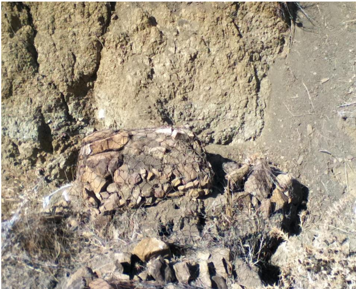
Photo n°03 : Destruction des gabions, zone de Torrich (commune d'Oued Lili)
