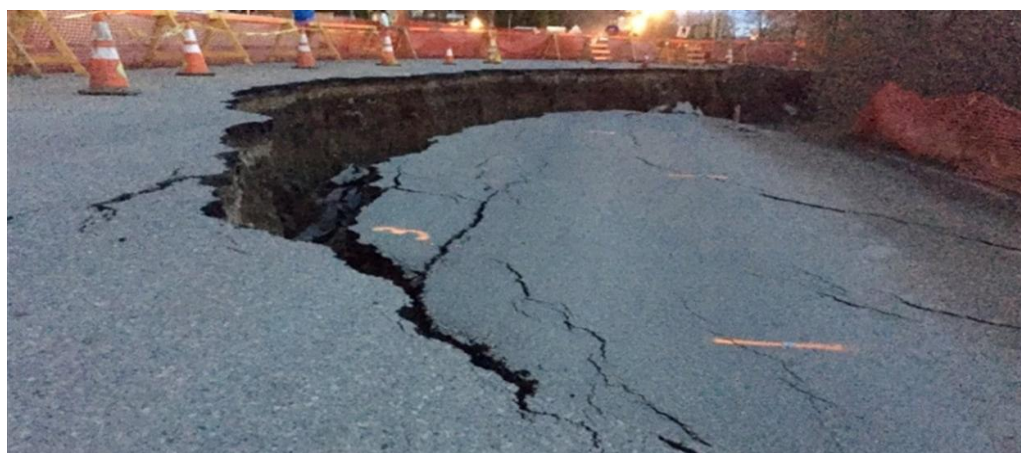
Figure II-4 : Affaissement d'un terrain
