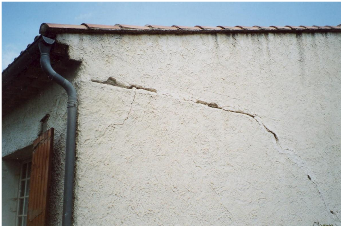
Figure II-3 : Maison fissurée en raison de terrain induits par la rétractation et le gonflement du sol argileux.
