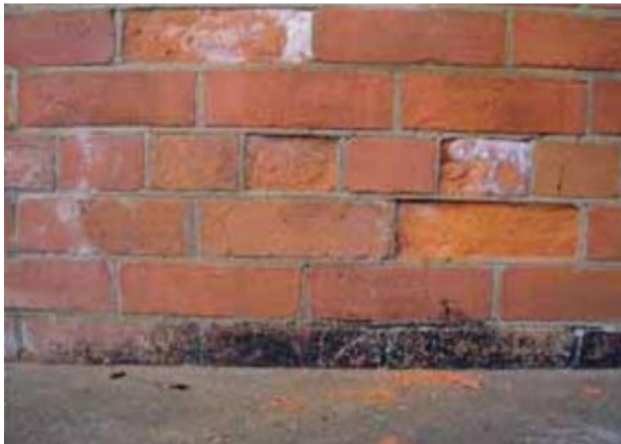
Figure III-7 : La dégradation d'un mur en brique par accumulation de sels
