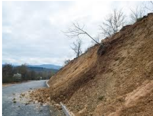
Figure 25 : glissement du talus
