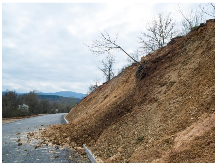
Figure IX4: affouillement du pied de talus.
