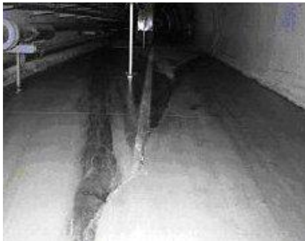
Figure 1.6 soulèvement puis dislocation du radier d'un tunnel
