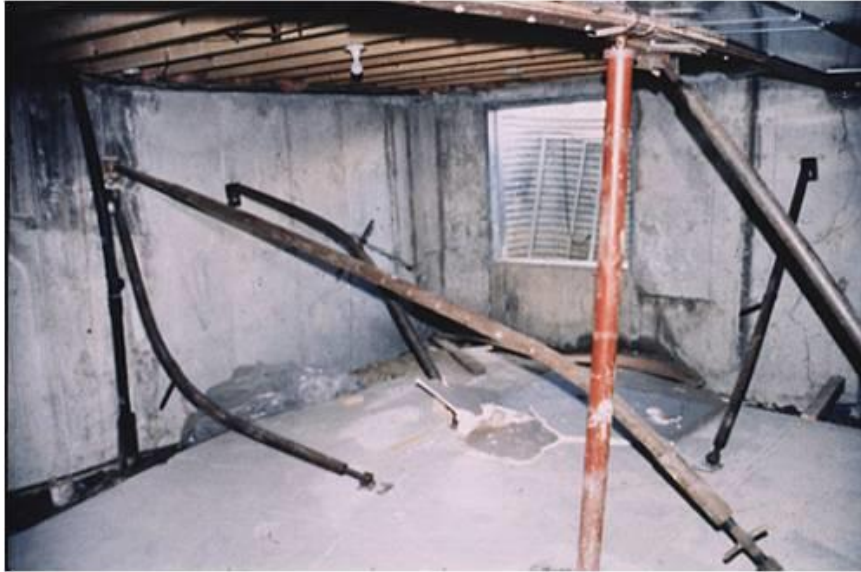
Figure 1.4 Dégradation du sous sol
