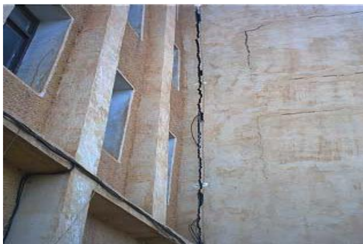
Figure 1.3 Ouverture des joints de dilatation entre les blocs
