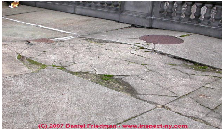
Figure 1.1 Fissuration des dalles en béton
