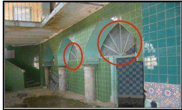
Figure 122: La salle froide (étage) 110
