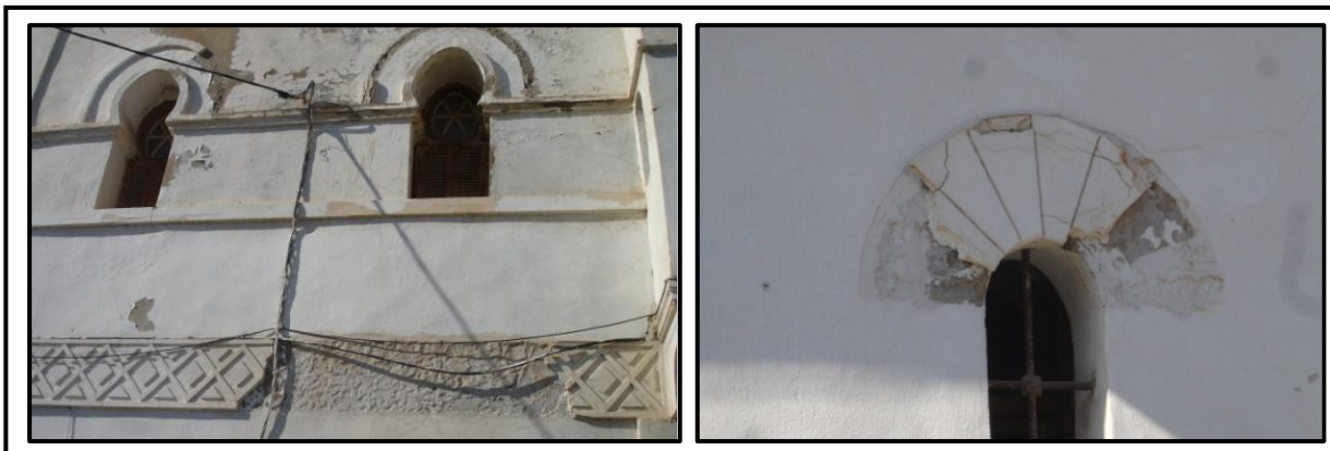
Figure 40: Installation de câbles électriques et le décollage de plâtre sur la façade 67
