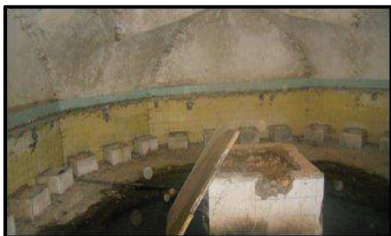
Figure 117: La salle froide (étage) 109
