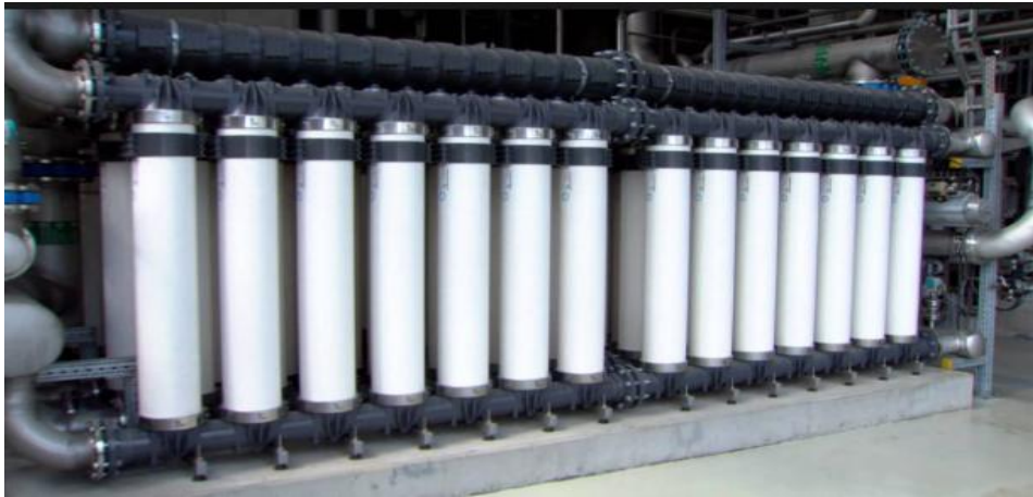
Fig. 14 : Présentation d'un train d'ultrafiltration.
