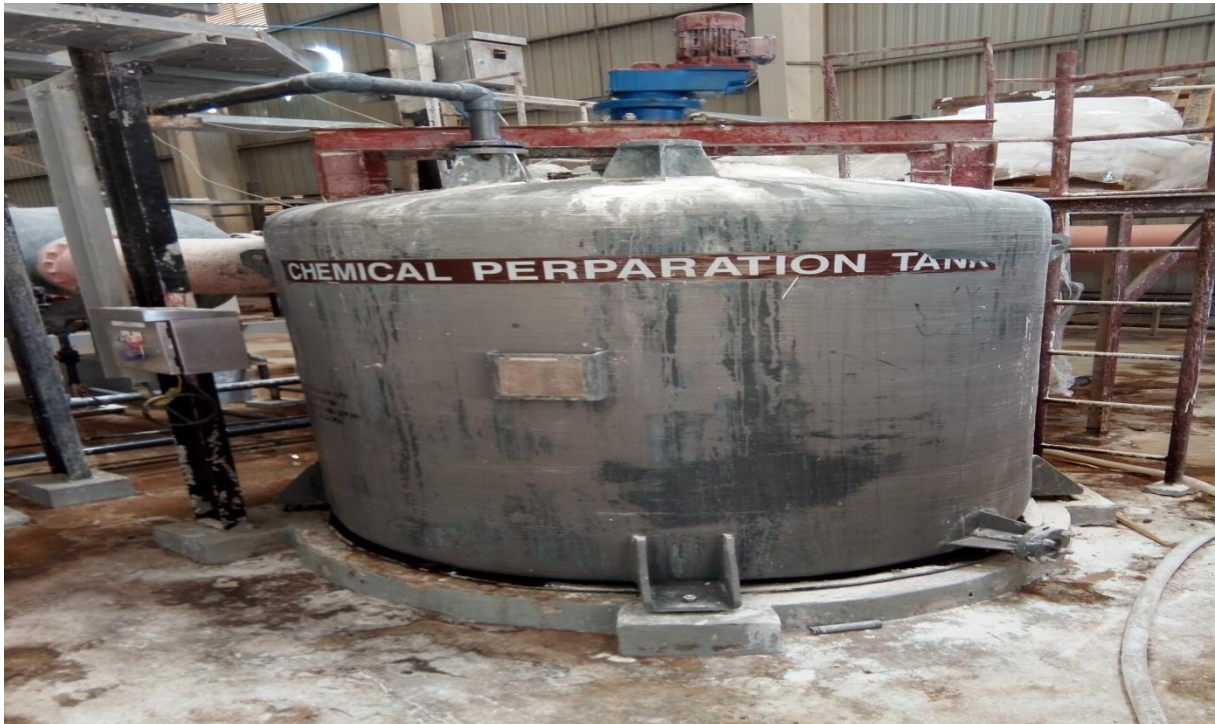
Fig. 18: Réservoir de contact eau/chlore.
