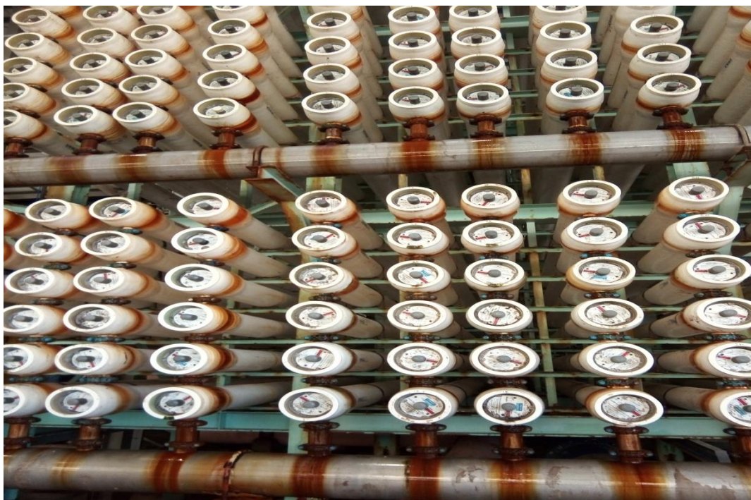
Fig. 17 : Train d'osmose inverse
