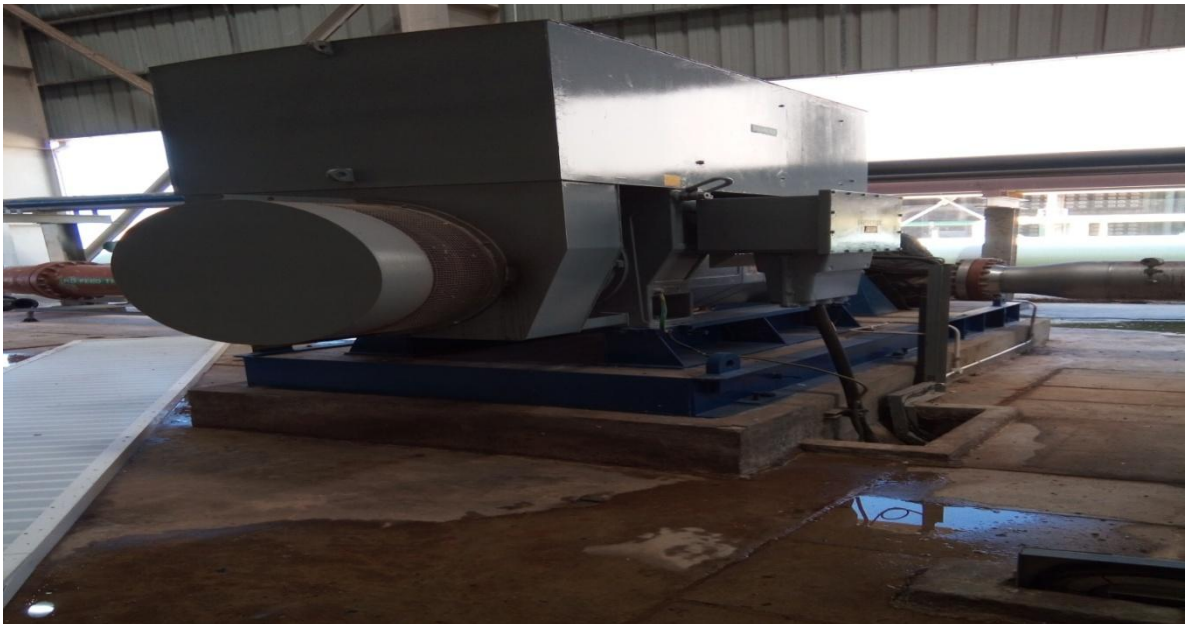
Fig. 16 : Pompe à haute pression.
