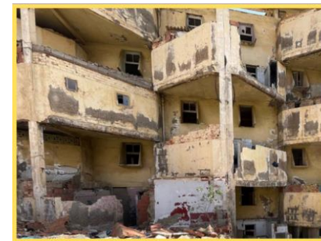
Bâtis en état dégradé
