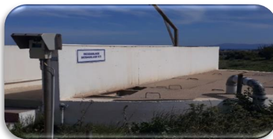
Figure n° III.6 : Dessaleur dégraisseur de la step cap falcon
