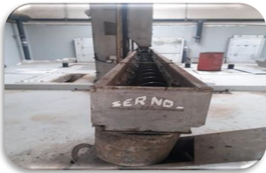
Figure n° III.5 : dégrillage fin de la step cap falcon
