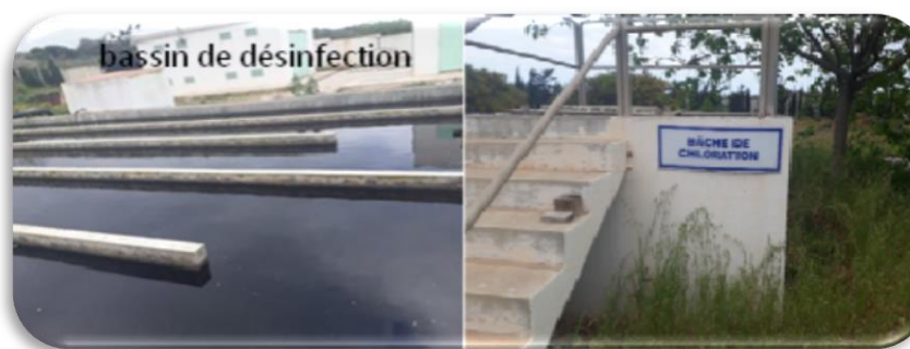
Figure n° III.13 : bassin de Désinfection de la step cap falcon
