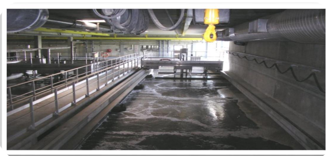
Figure n° II .4: Photo d'un bassin de dessablage – dégraissage .
