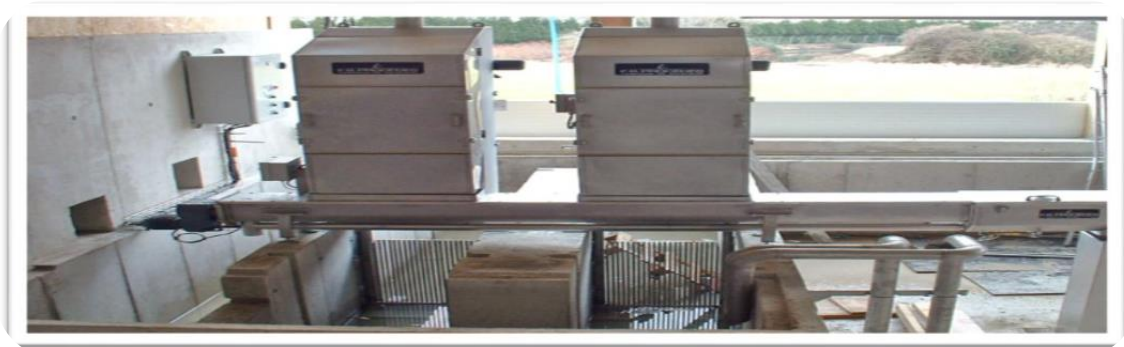
Figure n° II.2: Photo d'un dégrilleur automatique vertical .
