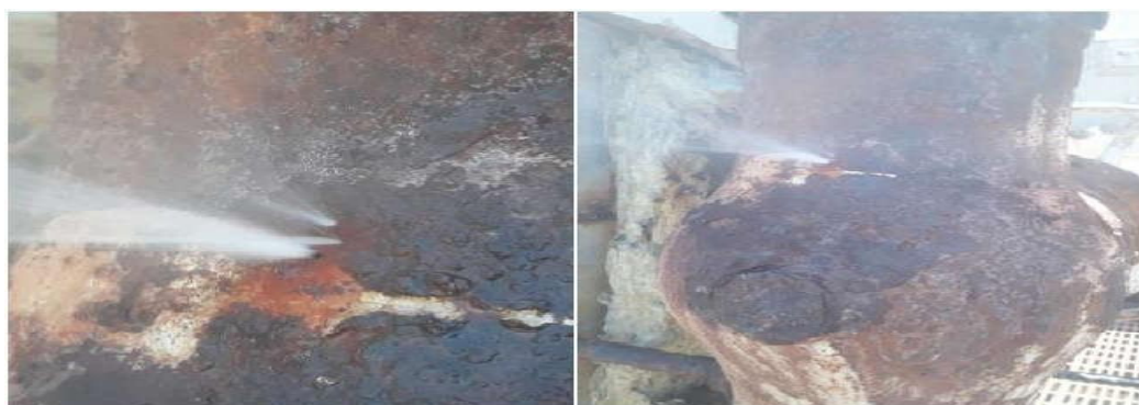
Figure III.6. Effet d'une corrosion par piqûre.
