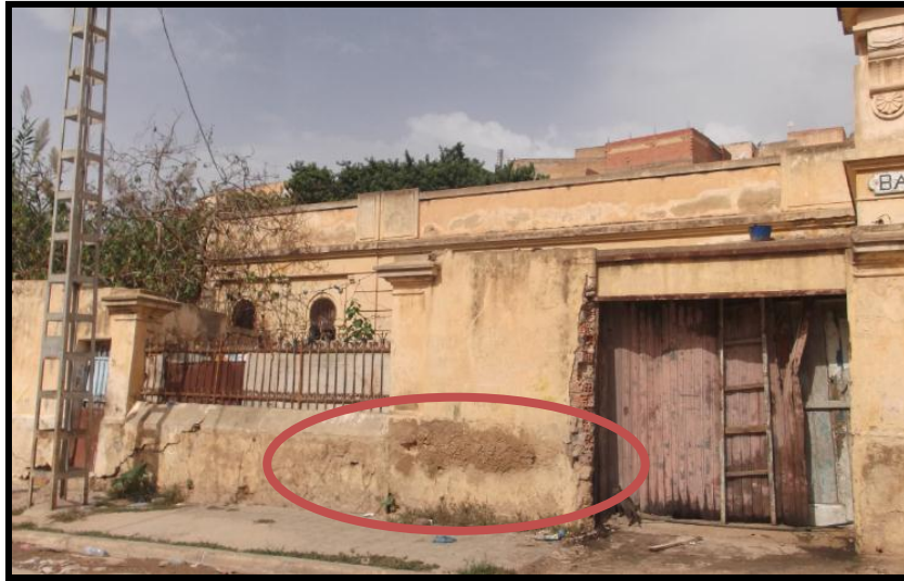
Fig. 2-18 : Humidité visible en pied de mur auteur du mémoire
