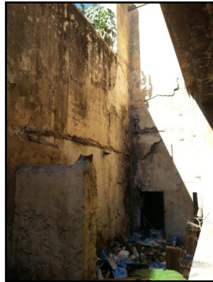
Fig. 2-21 : Les fissures et les salissures visibles auteur du mémoire
