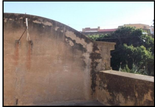
Fig. 2-29 : Dégradation de la gouttière et la présence les salissures noire auteur du mémoire
