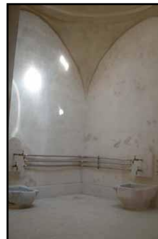
Fig. 2-86 : tuyauteries d'alimentation en eau
