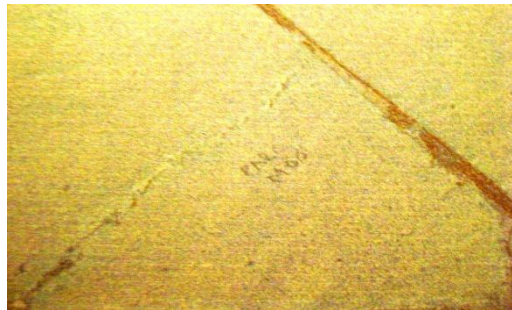
Figure 4.35 : Défaut de joint (parking)
