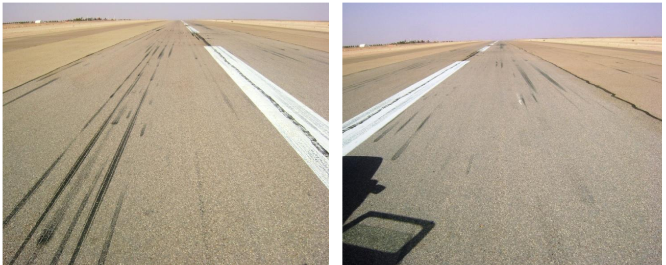
Figure 4.19 : Dépôt de gomme
