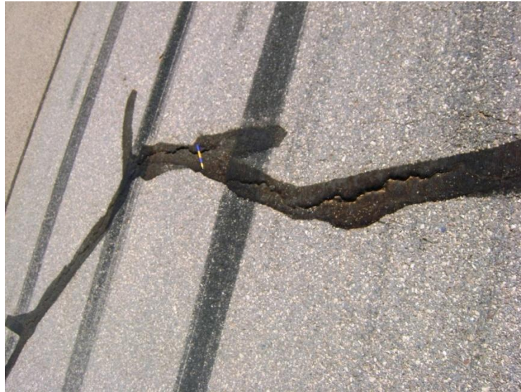
Figure 4.8 Fissure de retrait
