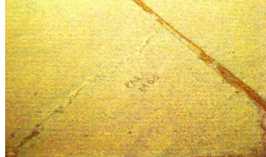
Figure 4.25 : Fissure élevée (parking)
