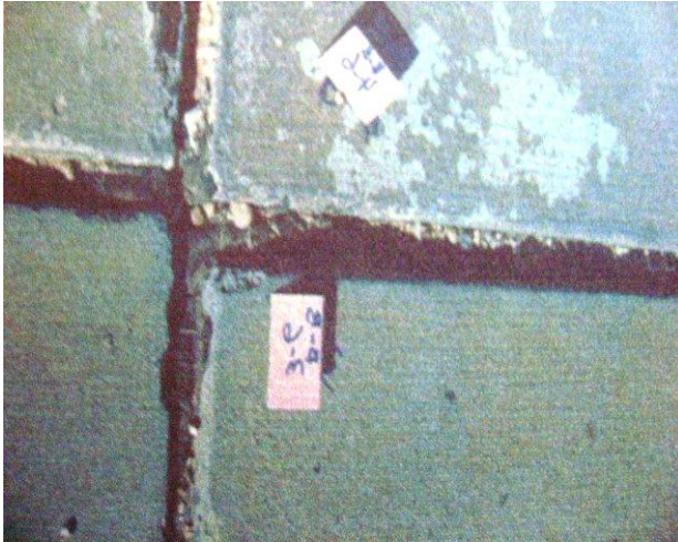
Figure 4.33 : Défaut de joint (bout bétonné N°01)
