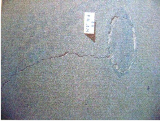
Figure 4.24 : Fissure élevée avec carottage existant (bout bétonné N°01)
