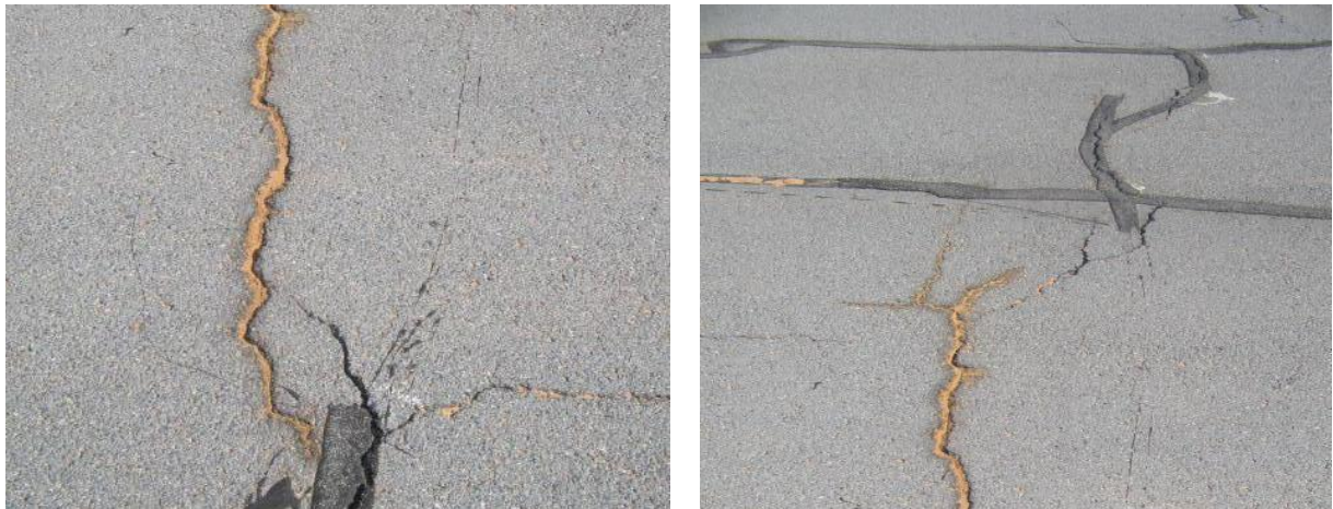
Figure 4.3 : Fissure de retrait élevé
