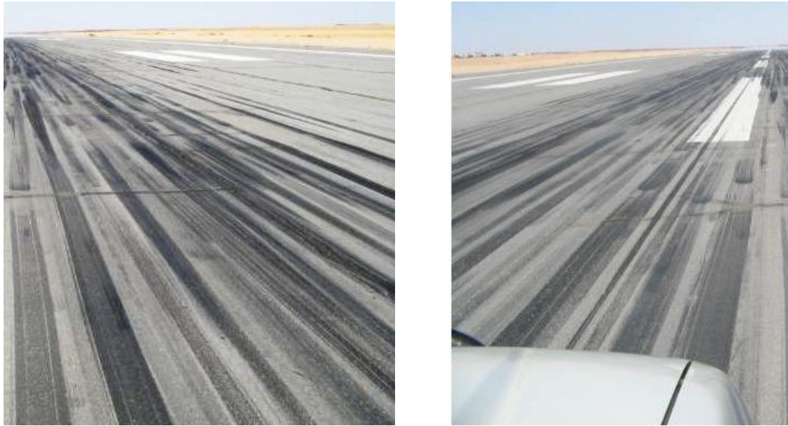
Figure 4.16 : Dépôt de gomme niveau élevé.
