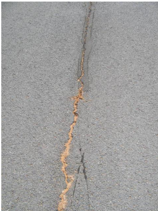
Figure 4.1 : Fissure de joint d'un niveau élevé
