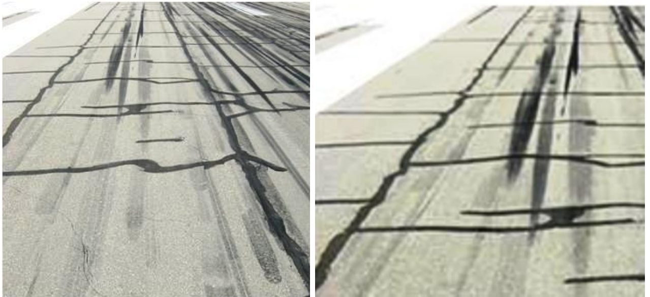
Figure 4.6 : Faïençage généralisé et dépôt de gomme
