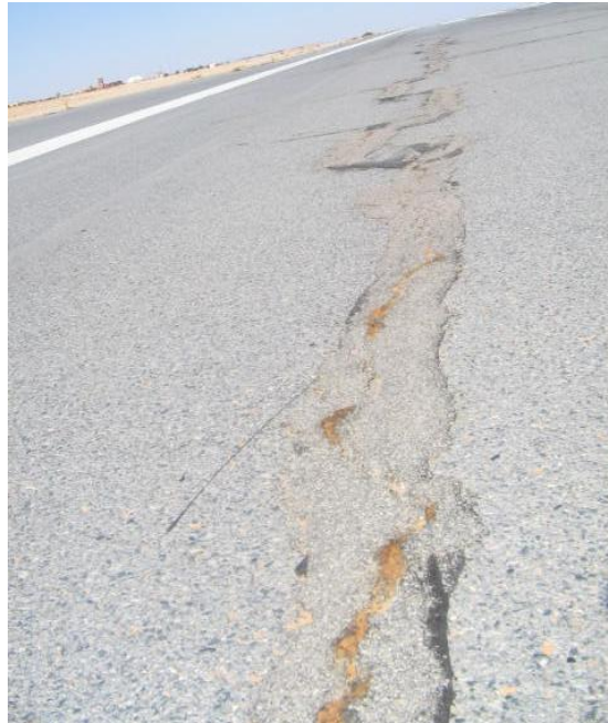
Figure 4.17 : Réparation ponctuelle dégradée Dépôt du sable dans le joint
