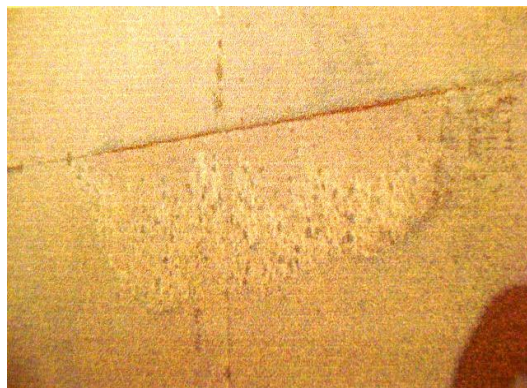
Figure 4.32 : Ecaillage d'un degré élevé (bout bétonné N°19)
