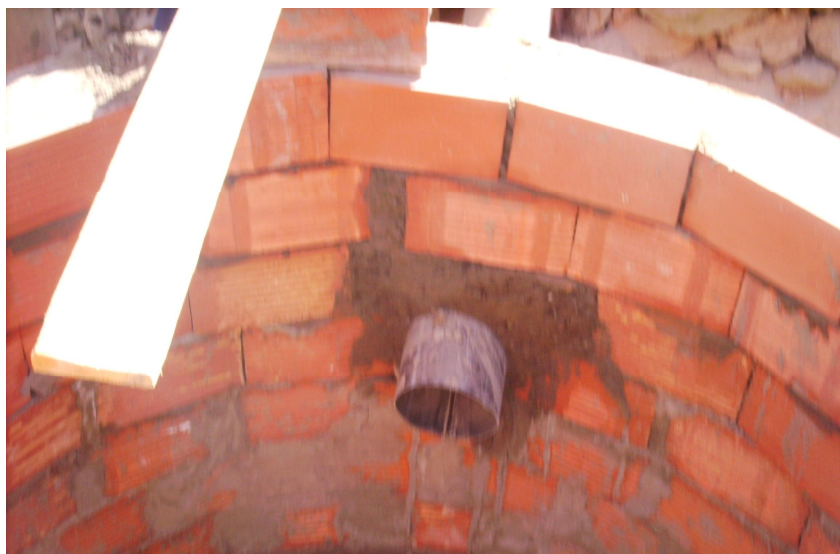
Photo 10. Tuyau d'alimentation du digesteur
