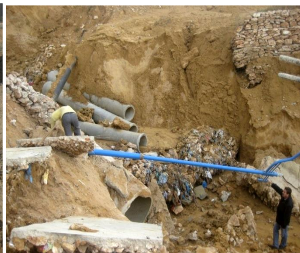
Figure 3.9. Destruction des ouvrages de soutènement
