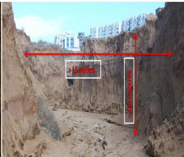
Figure 3.13. Effondrement totale du talus
