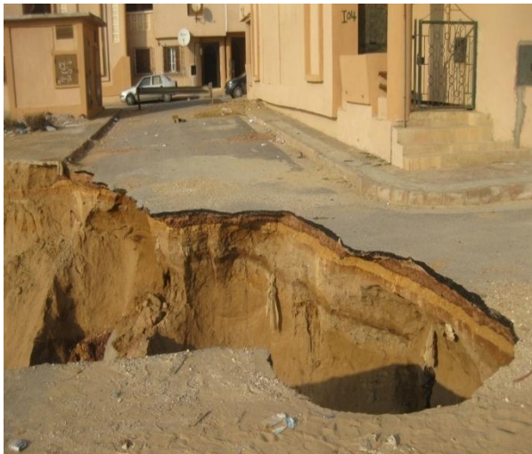
Figure 3.10. Effondrement de talus au pied de bâtiment
