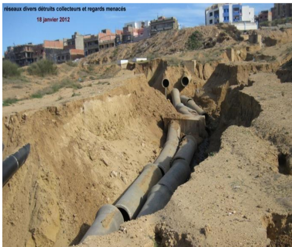
Figure 3.8. Destruction des réseaux d'assainissement
