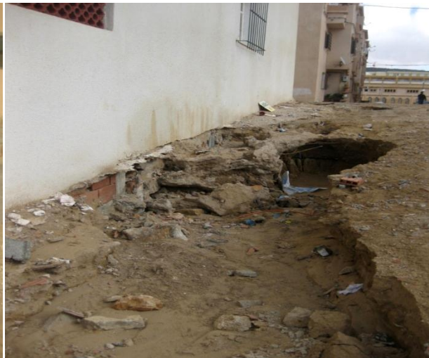
Figure 3.11. Déchaussement des fondations de bâtiments
