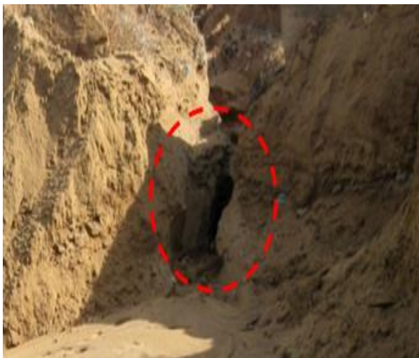
Figure 3.12. Début de formation d'une brèche
