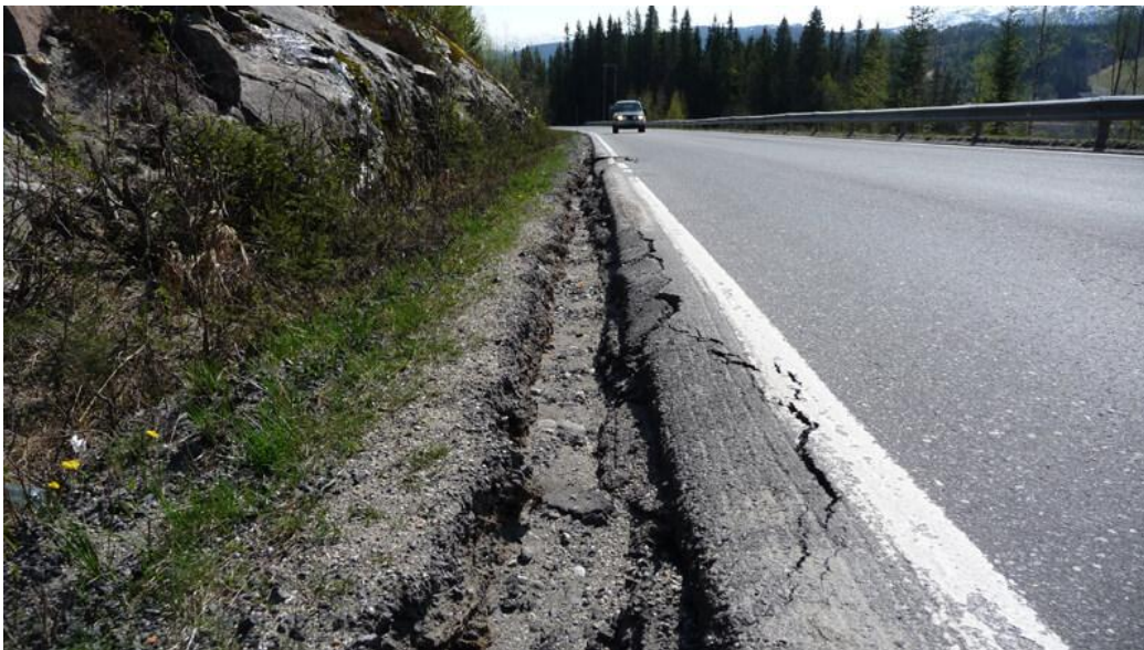
Figure II.11 : Fissure parabolique de glissement
