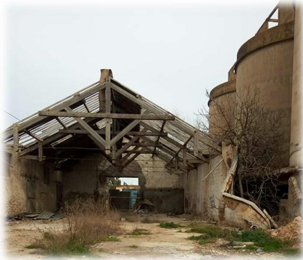
Figure 30 : Des dégradations structurelles sur la toiture (Source_2018 : L'auteur )
