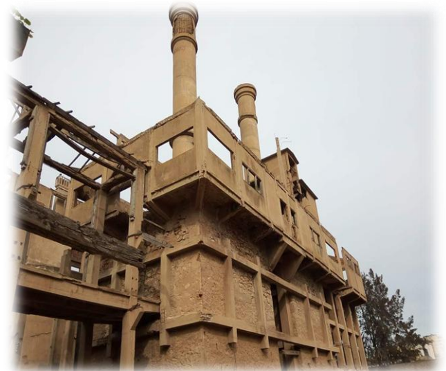
Figure 33 : Des dégradations superficielles avec des fissures due au mouvement différentiel de la jonction de deux matériaux la pierre et le béton. (Source_2018 : L'auteur )
