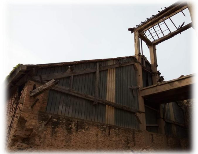
Figure 31 : Des traces d'humidité due à la stagnation et à l'infiltration d'eau pluviale avec des fissures sur le mur extérieur. (Source_2018 : L'auteur )
