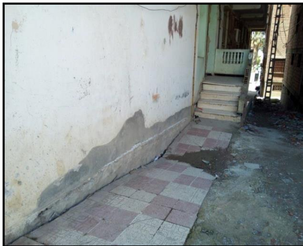
Figure II.3 : Désordres due au gonflement (Photo prise à Tizi-Ouzou)
