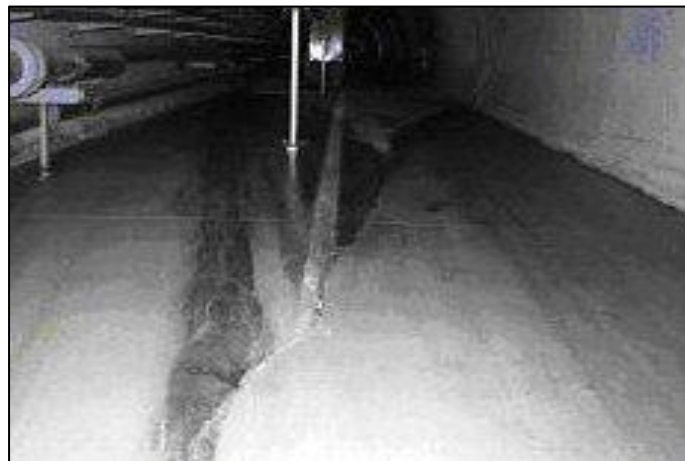
Figure II.6 : Soulèvement puis dislocation du radier d'un tunnel
