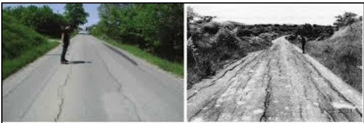
Figure II.5 : Fissure longitudinales sur routes
