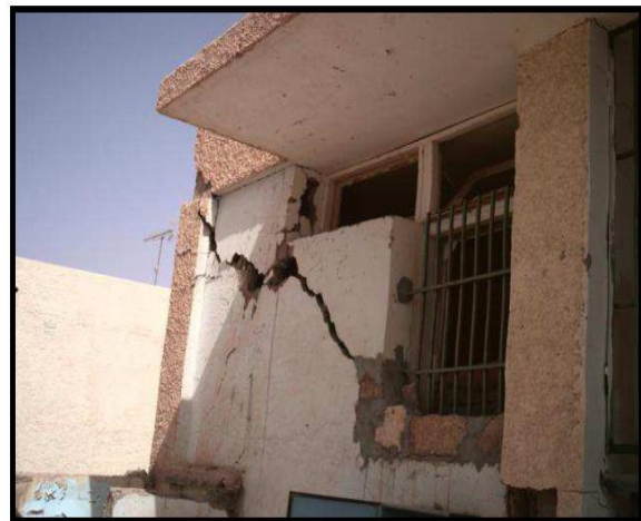
Figure II.4 : Fissure sur les murs (Zenk,2010)
