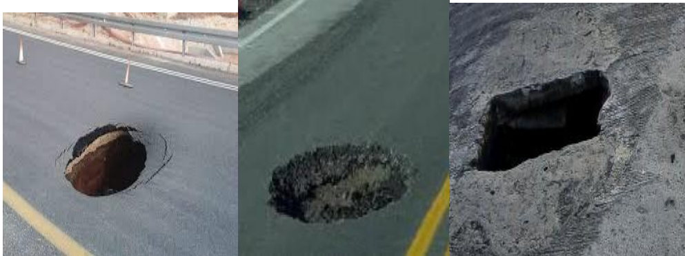
Figure 3.3 : Exemple des obstacles dans la route présentant des nids de poules.
