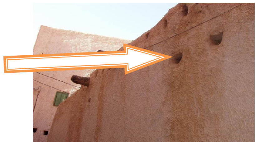
Photo 75: Des percements dans La maçonnerie
