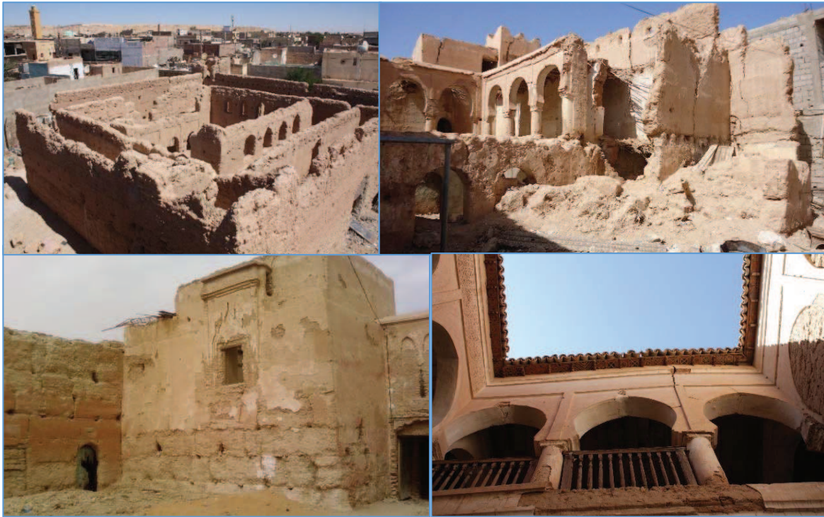
Photo P3 : représente les dégradations de l'état bâti du noyau historique.
