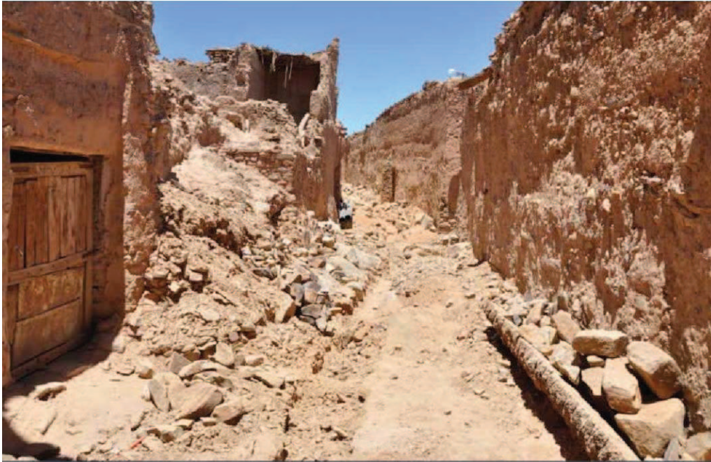
Photo 3.11 : Etat de dégradation du ksar.
