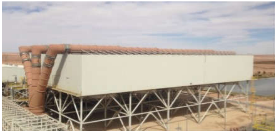
Figure II-19 : Aérocondenseurs de la centrale de Hassi R'mel
