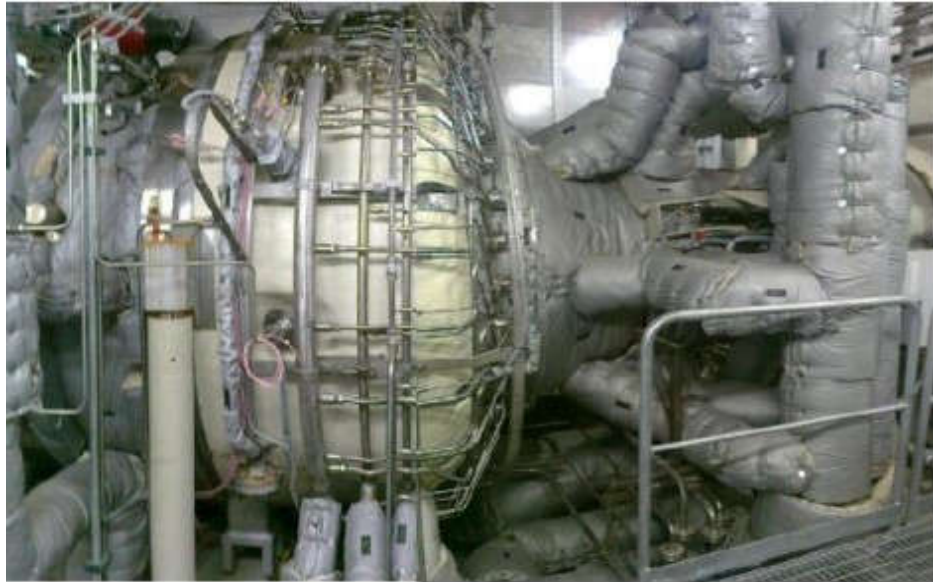
Figure II-14 : La turbine à gaz SIEMENS SGT-800
