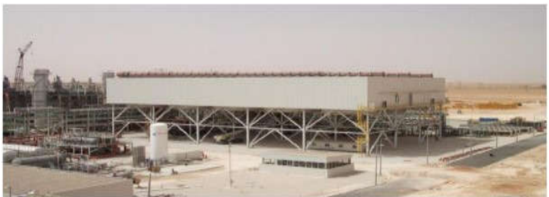
Figure II-20 : Aérocondenseurs SPX de la centrale
