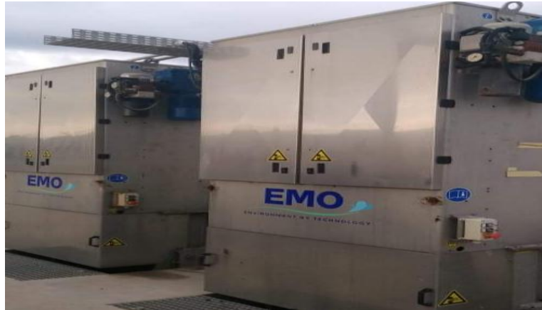
Photo N°3 : Dégrillage fin (photo prise à la station)
