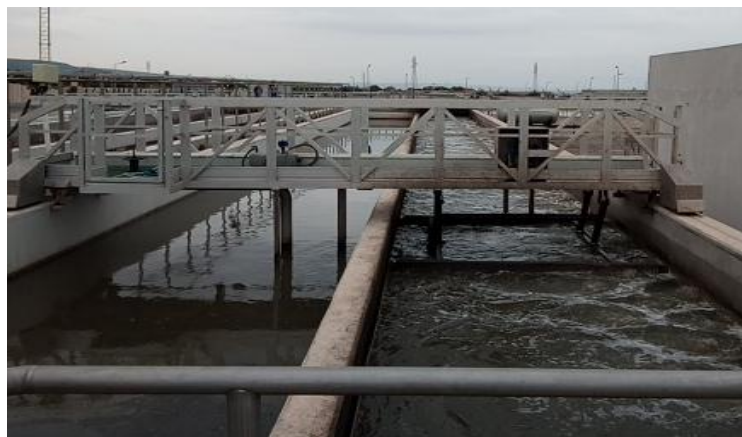
Photo N°4 : Dessablage — Déshuilage (photo prise à la station)
