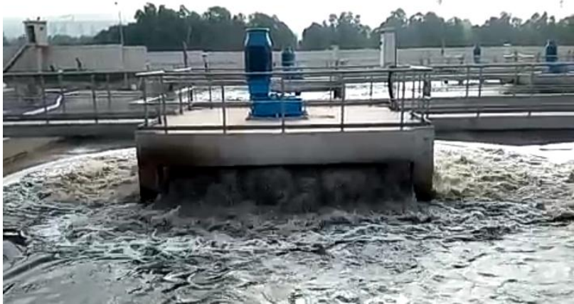
Photo N°6 : Bassin d'aération (photo prise à la station)
