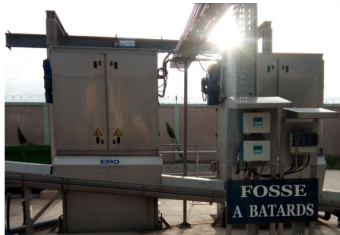
Photo N°2 : dégrillage grossier (photo prise à la station)
