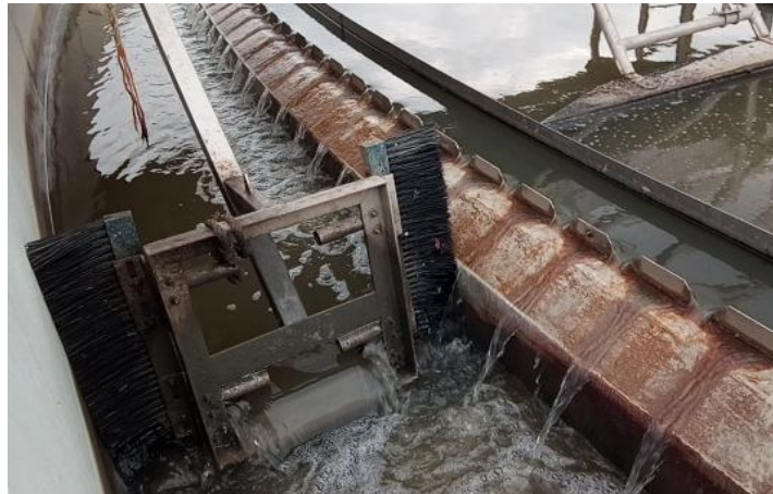
Photo N°5: Décanteur primaire (photo prise à la station)
