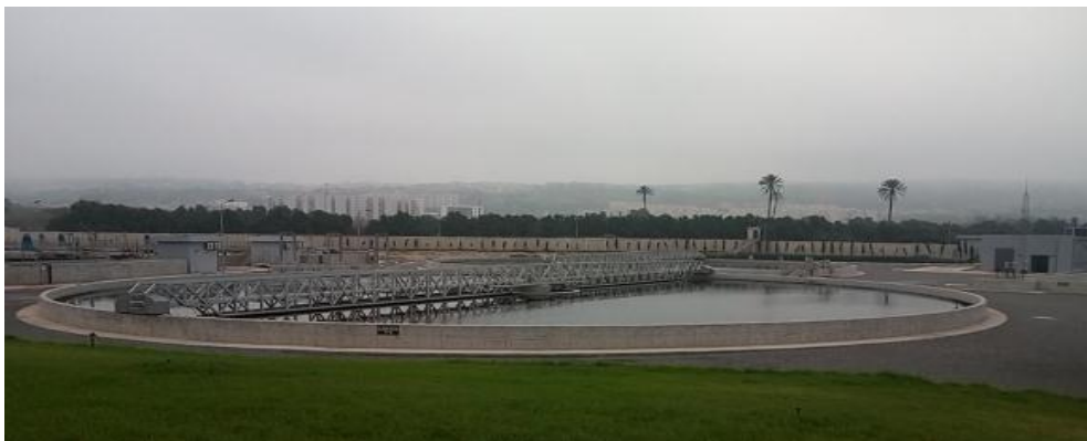
Photo N°7: Décantation secondaire (photo prise à la station)
