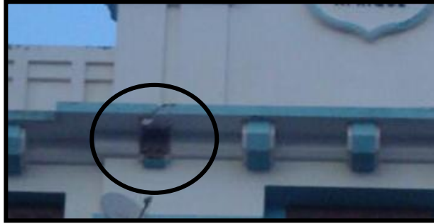
Photo. 3.6 Un corbeau complètement détruit sur la façade de BNCI
