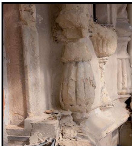
Photo 1.9 L'état des ornements avant la restauration [Restauration auvergnats,2012]
