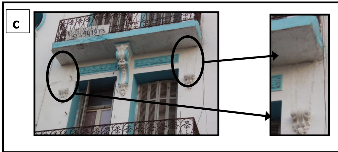
Photo 3.22 Décollement partiel d'un ornement de la façade de l'immeuble d'habitation N° 2
