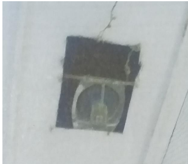
Figure n°02 : Extracteur placé en haut du bâtiment
