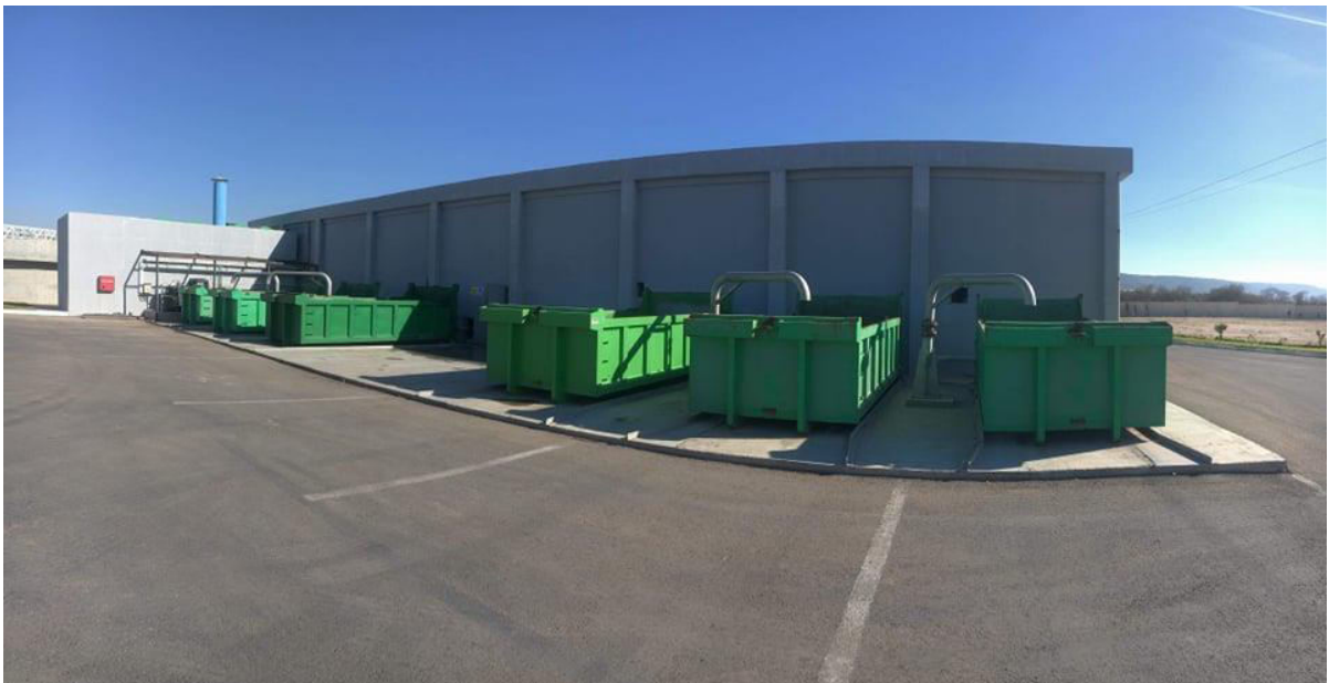
Figure II.12: Stockage de boues déshydratées
