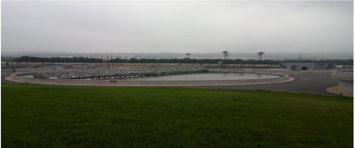
Figure II.7: Décanteur secondaire (clarificateur)
