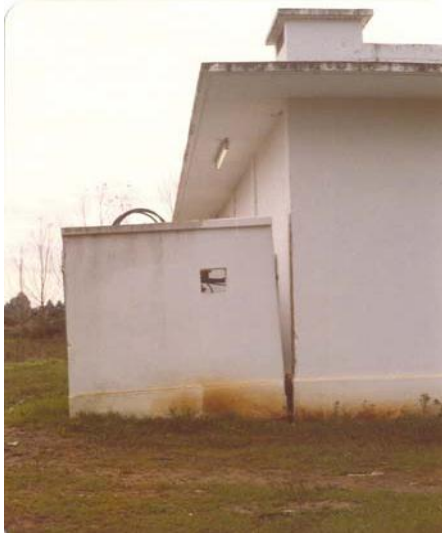
Figure I.35 : Tassement différentiel du terrain sous Les fondations d'une station de pompage (SP13, Garb)
