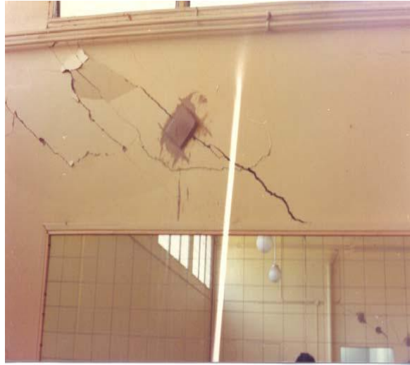
Figure I.36 : Hôpital Moulay Ismail, (Meknès) dégradations dues au gonflement du sol
