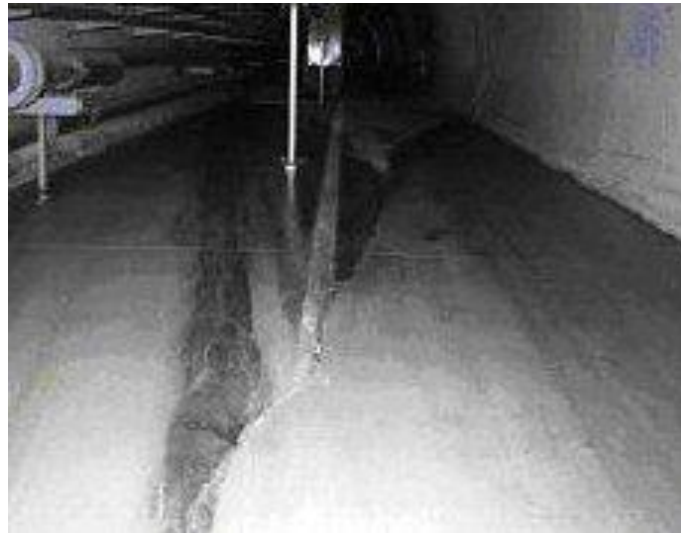
Figure I.37: Soulèvement puis dislocation du radier d'un tunnel
